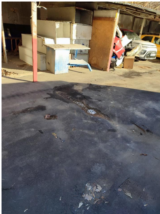
Фото 5.9. Провал асфальтового покрытия и грунта на прилегающей территории
