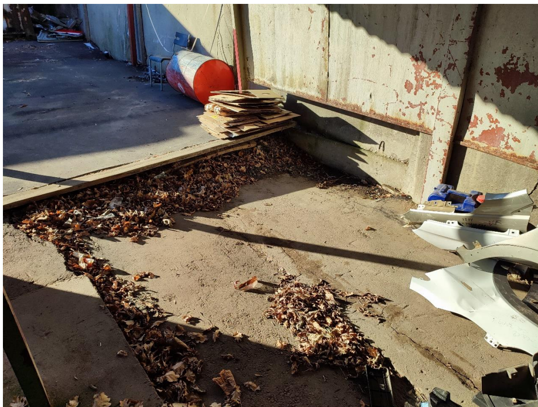
Фото 5.10. Провал асфальтового покрытия и грунта на прилегающей территории
