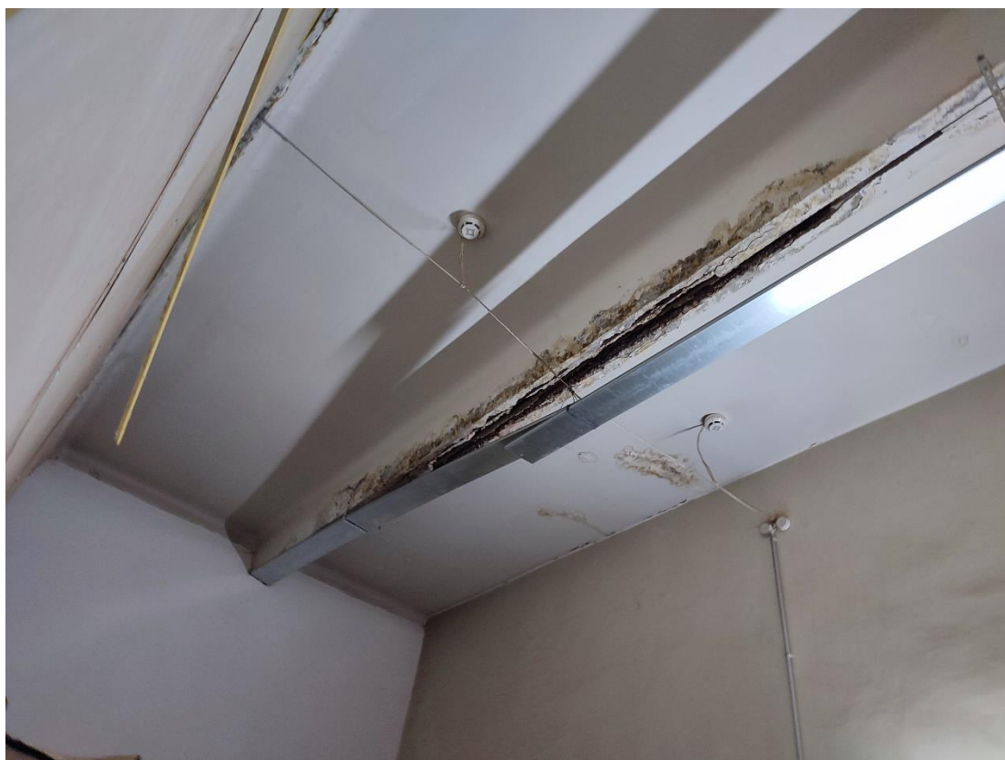
Фото 5.2. Следы протечек, коррозия арматуры, разрушение ребер плит перекрытия проема в осях 1-2/А-Б
