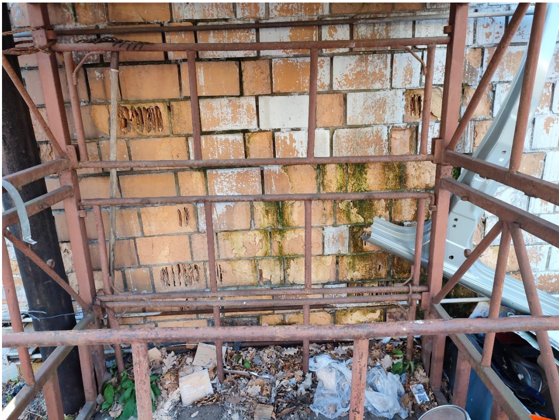
Фото 5.8. Отслоение лещадки кирпича и биологическое поражение кирпичной кладки фасада в осях 4-3/Б
