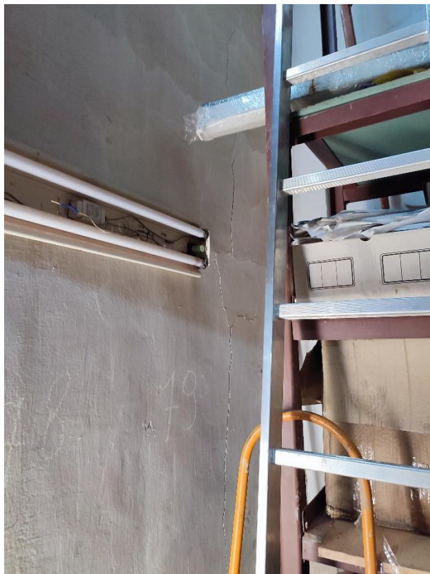
Фото 5.1. Вертикальная трещина в наружной стене в осях 1-2/А шириной раскрытия 0,6 мм
