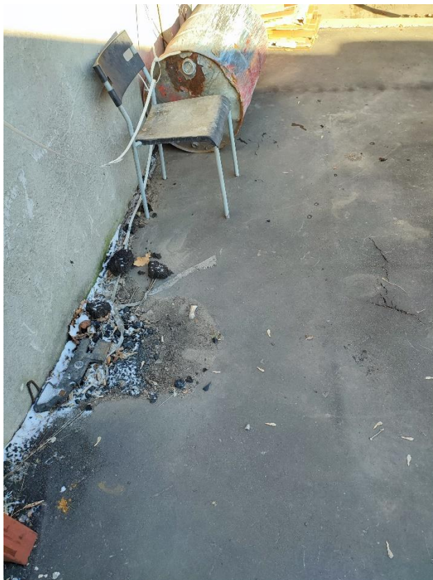
Фото 5.3. Провал асфальтового покрытия и грунта у забора, примыкающего к зданию в осях 1/Б
